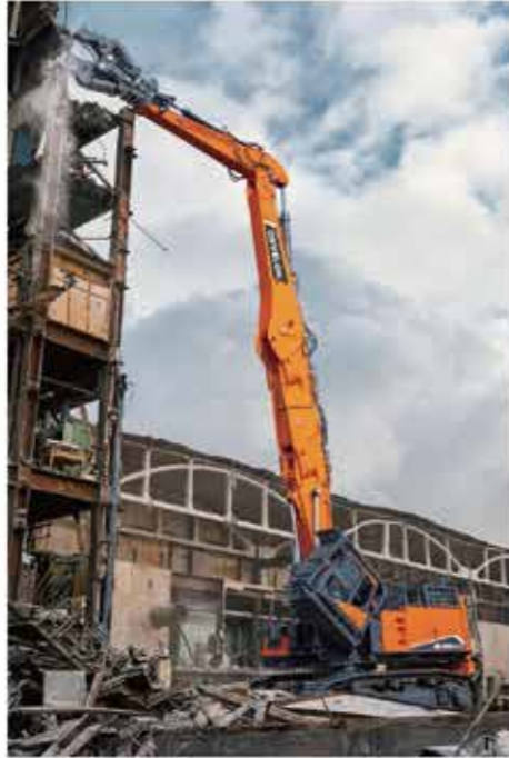
철거 가능 높이 22m : 디깅 Front + 연장 보조봉 장착 장착 가능 옵션 55톤급 칩클램프, 크라샤
